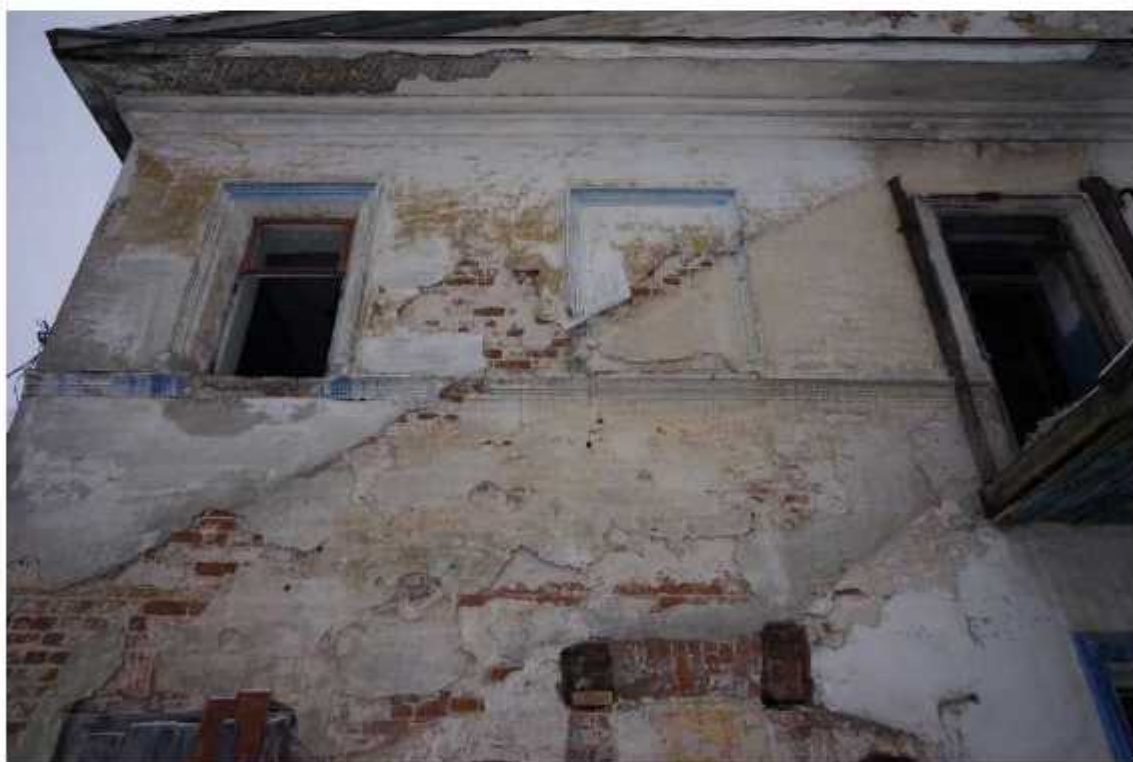
Фото 33. Фрагмент северного фасада. Наблюдаются разрушения штукатурного и окрасочного слоев, обнажение и деструкция кирпичной кладки, утрата декора, следы утраченной лестницы.
