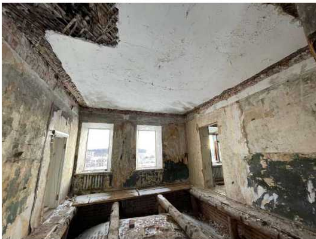
Фото 72. Помещение первого этажа главного объема. Наблюдаются потери, отслоения отделочного и штукатурного слоев, разрушения деревянного перекрытия, следы загрязнений и биопоражений.
