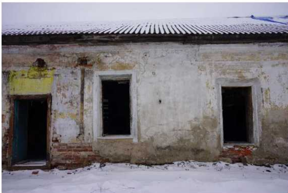
Фото 24. Фрагмент западного фасада восточного крыла. Наблюдаются разрушения штукатурного и окрасочного слоев, обнажение и деструкция кирпичной кладки, отсутствие оконных и дверного заполнений, утрата декора. Видны следы поздних ремонтов оконных и дверного проемов, разрушение участка карниза. Отсутствует отмостка здания.
