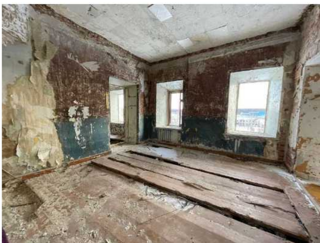
Фото 73. Помещение первого этажа главного объема. Наблюдаются утраты отделочных и штукатурного слоев, оголение кирпичной кладки, деформация деревянного пола, отсутствие дверных и оконных заполнений, следы биопоражений и загрязнений.
