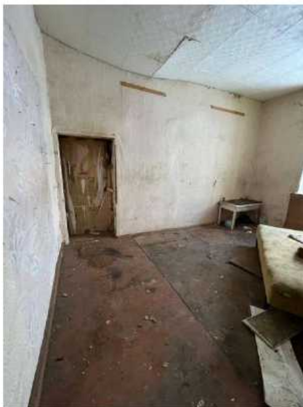
Фото 58. Помещение первого этажа восточного крыла. Наблюдаются провисания потолка, следы замокания и биопоражений, провисания покрытия пола. Разрушение и загрязнения отделочного слоя поверхности стен.
