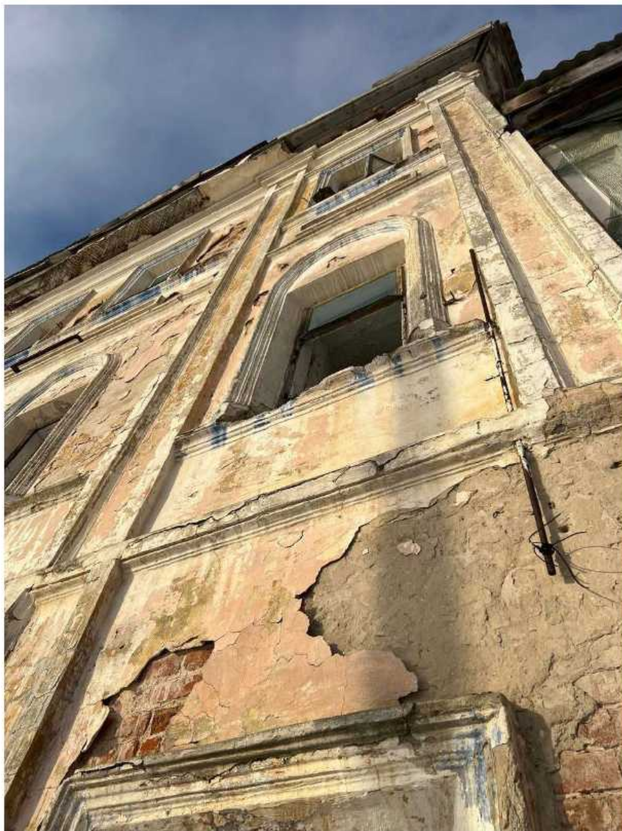
Фото 12. Фрагмент южного фасада (центральный объем, правый фланг). Наблюдаются разрушения штукатурного и окрасочного слоев, обнажение и деструкция кирпичной кладки, трещины с шириной раскрытия более 10 мм. Утраты штукатурного декора (наличники, карнизы, пояски и пилястры). Отсутствуют заполнения оконных проемов. Наблюдается частичная утрата кровельного покрытия.
