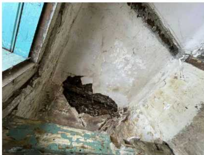
Фото 90. Помещение второго этажа главного объема. Наблюдаются обрушения отделочного и штукатурного слоев, следы намокания, биопоражений и загрязнения, оголение и деструкция деревянного перекрытия.
