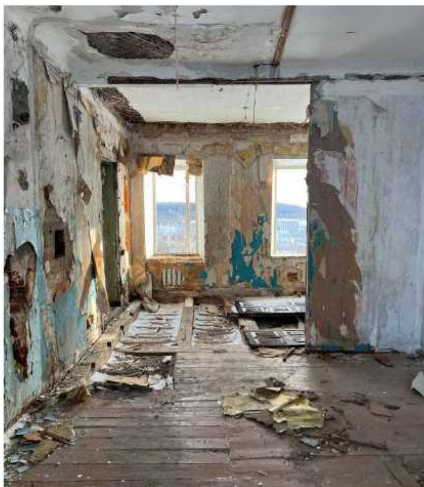
Фото 71. Помещение первого этажа главного объема. Наблюдаются следы разрушений, утраты отделочных и штукатурного слоев, обнажение кирпичной кладки, разрушения деревянного пола, следы прогибов, отсутствие оконных заполнений, многочисленные загрязнения.
