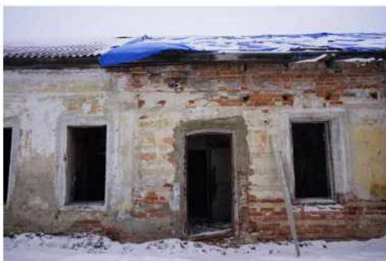
Фото 23. Фрагмент западного фасада восточного крыла. Наблюдаются разрушения штукатурного и окрасочного слоев, обнажение и деструкция кирпичной кладки, отсутствие оконного и дверного заполнений, утрата декора. Отсутствует отмостка здания. Видны значительные разрушения подкровельных конструкций и отсутствие кровельного покрытия.
