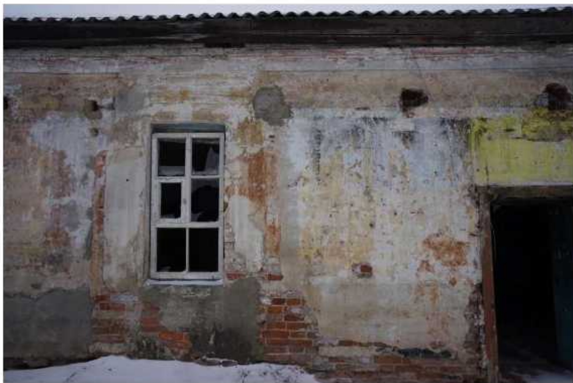
Фото 25. Фрагмент западного фасада восточного крыла. Наблюдаются разрушения штукатурного и окрасочного слоев, обнажение и деструкция кирпичной кладки, отсутствие дверного заполнения, утрата декора. Видны следы поздних ремонтов, разрушение участка карниза. Отсутствует отмостка здания.
