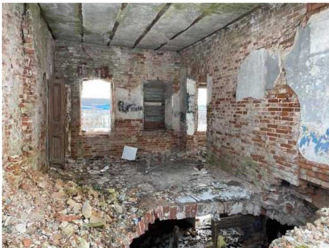
Фото 68. Помещение первого этажа западного крыла. Наблюдаются утраты отделочного и штукатурного слоев, обрушение кирпичного свода, оголение и деструкция кирпичной кладки, отсутствие оконных заполнений.
