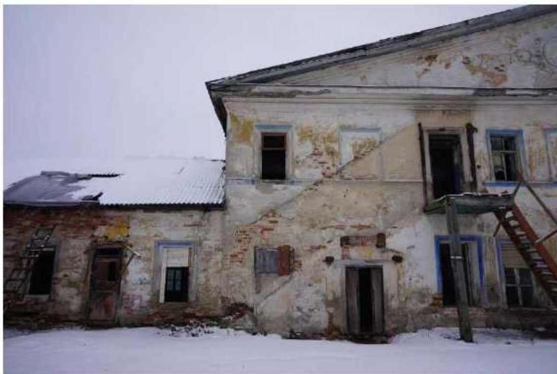
Фото 32. Фрагмент северного фасада. Наблюдаются разрушения штукатурного и окрасочного слоев, обнажение и деструкция кирпичной кладки, утрата декора, разрушения оконных и дверного заполнений, отсутствие отмостки. Видны следы поздних ремонтов со времен перепланировки здания.
