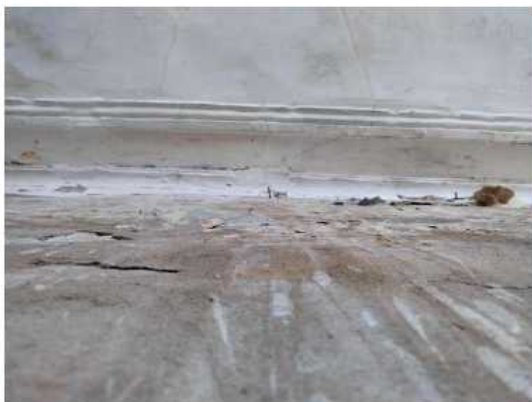
Фото 47. Помещение цокольного этажа главного объема. Наблюдаются утраты отделочного слоя поверхностей, отслоение штукатурного слоя, многочисленные трещины, следы замокания, очаги биопоражений.
