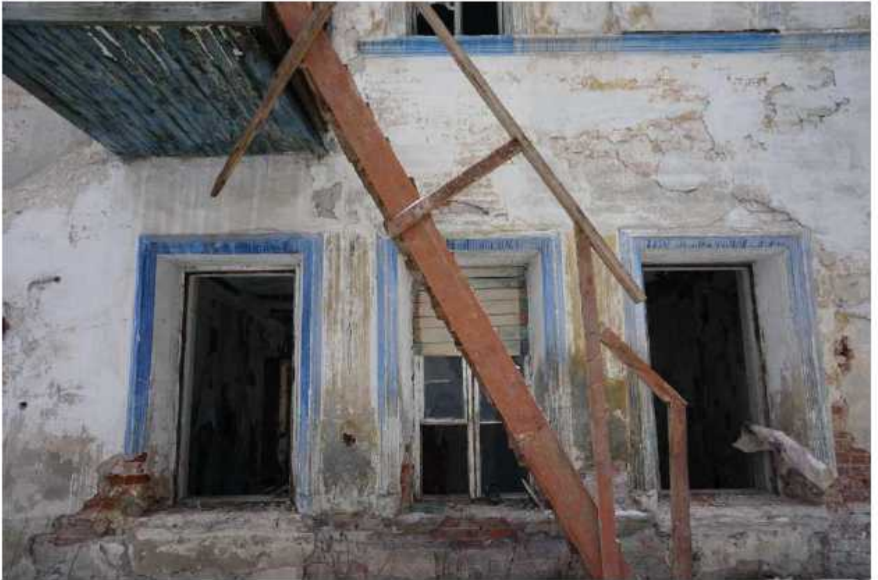
Фото 36. Фрагмент северного фасада. Наблюдаются расслоение и утраты штукатурного и окрасочного слоев, обнажение и деструкция кирпичной кладки, локальные утраты оконных проемов, декора.
