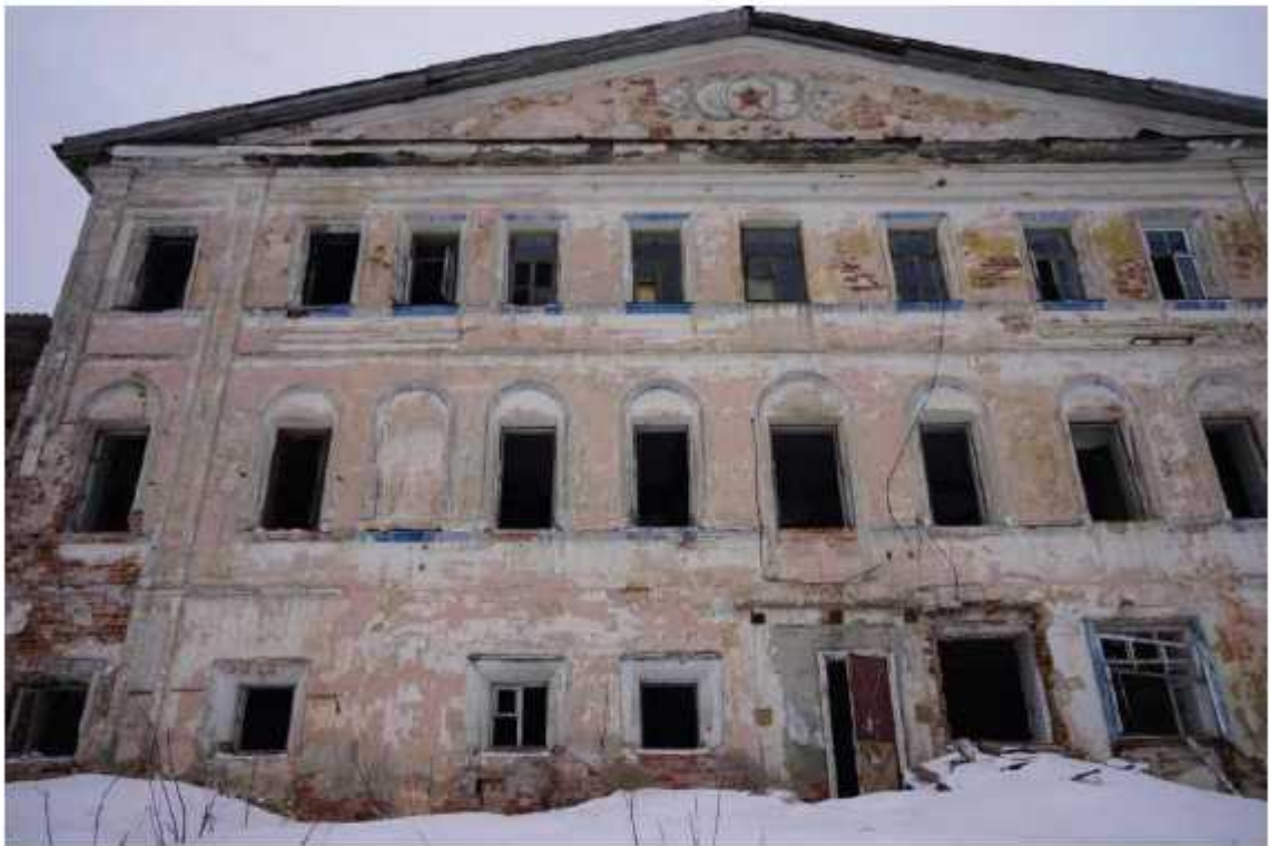
Фото 7. Фрагмент южного фасада (центральный объем). Наблюдаются разрушения штукатурного и окрасочного слоев, трещины с шириной раскрытия более 10 мм. Утраты штукатурного декора, обнажение и деструкция кирпичной кладки. Отсутствуют отмостка здания, заполнения оконных проемов, наблюдаются следы позднего ремонта.
