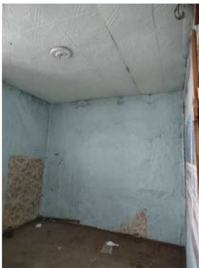
Фото 57. Помещение первого этажа восточного крыла. Наблюдаются трещины, локальные утраты отделочного слоя стен и следы загрязнения, деформации покрытий пола и потолка.
