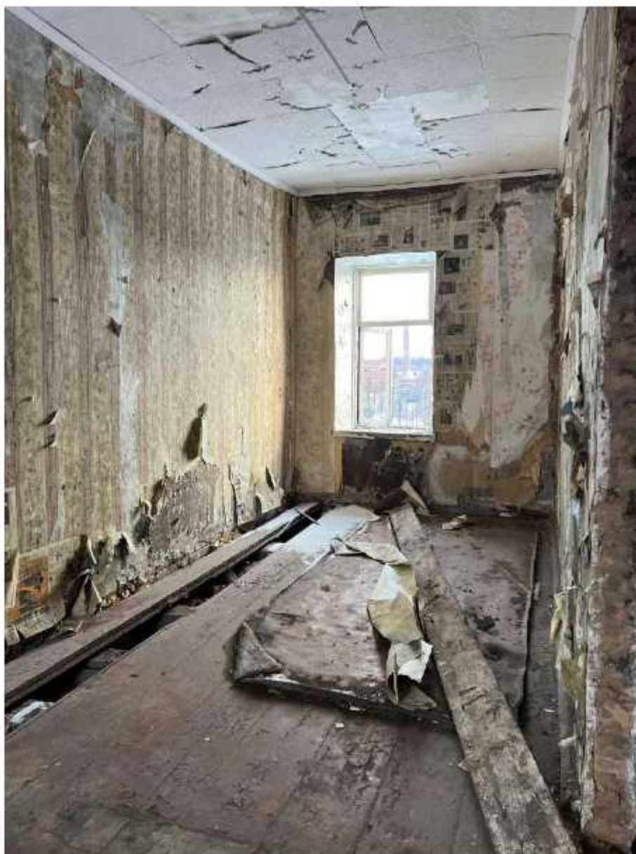
Фото 80. Помещение второго этажа главного объема. Наблюдаются потери, отслоения отделочных слоев, рассыхание, деформация деревянного перекрытия, следы загрязнений и биопоражений.
