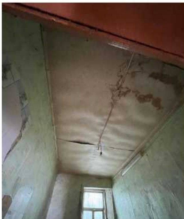
Фото 54. Помещение первого этажа восточного крыла. Наблюдается отслоение и деформация отделочного слоя потолка, следы замочания и биопоражений, потеря цветового облика, загрязнения и отслоения отделки стен.
