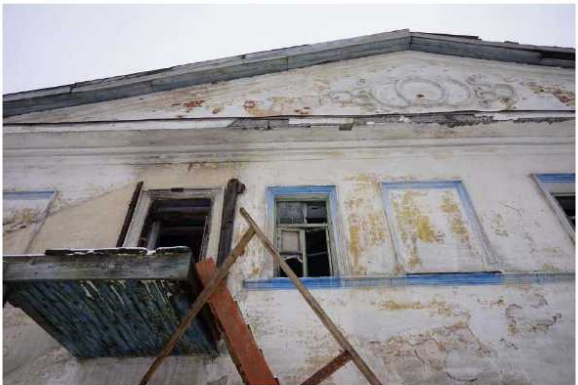
Фото 35. Фрагмент северного фасада. Наблюдаются разрушения штукатурного и окрасочного слоев, обнажение и деструкция кирпичной кладки, утрата декора.
