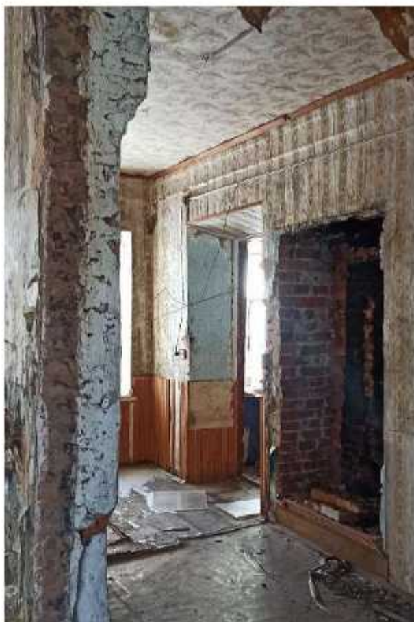
Фото 82. Помещение второго этажа главного объема. Наблюдаются следы разрушений, утраты отделочных и штукатурного слоев, оголение, деструкция кирпичной кладки.
