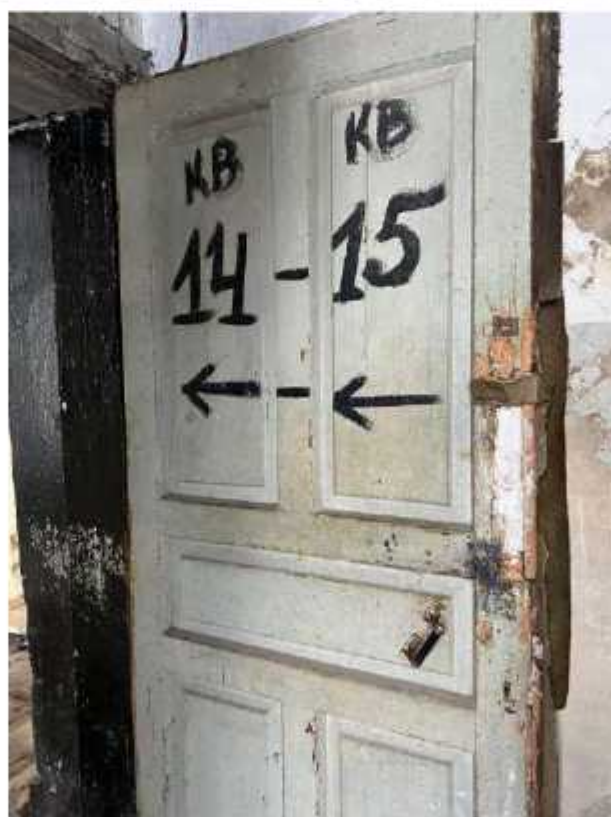
Фото 77, 78, 79. Помещение второго этажа главного объема. Наблюдаются утраты отделочного и штукатурного слоев, загрязнения, следы биопоражений, потеря цветового облика, деформация деревянного пола, сохранившееся дверное заполнение.
