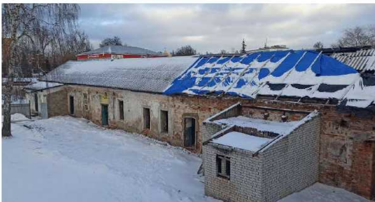
Фото 10. Западный фасад восточного крыла. Наблюдаются следы разрушений, вызванных пожаром (разрушение подкровельных конструкций и кровельного покрытия, утраты штукатурного и окрасочного слоев, обнажение и деструкция кирпичной кладки, утраты декора, оконных и дверных заполнений, отмостки здания. Видны поздние пристройки.
