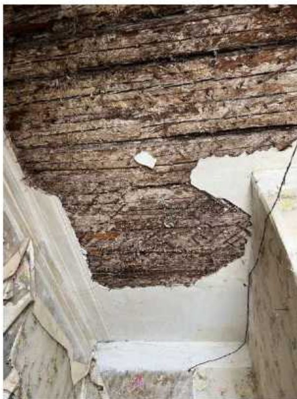
Фото 52. Помещение первого этажа восточного крыла. Наблюдаются обрушения отделочного и штукатурного слоев, следы биопоражений, трещины и рассыхания деревянных поверхностей.
