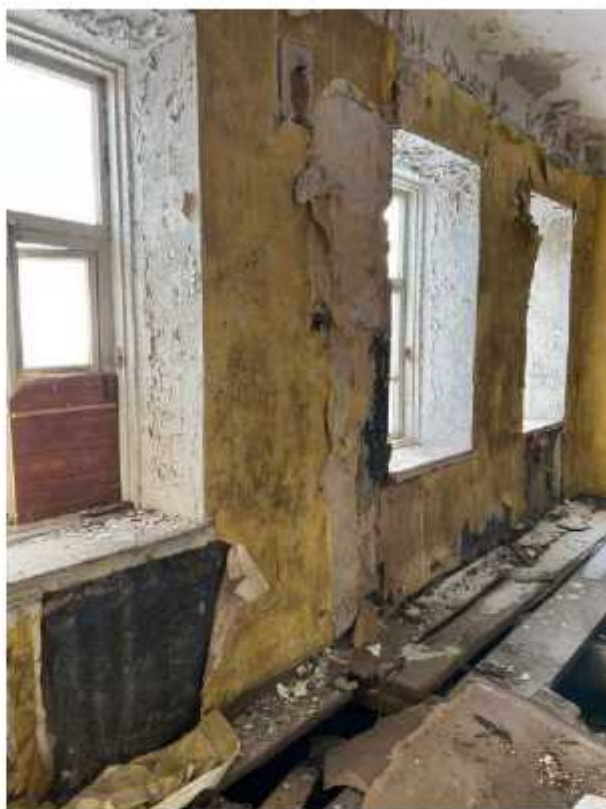
Фото 86. Помещение второго этажа главного объема. Наблюдаются утраты, отслоения отделочного и штукатурного слоев, утрата системы отопления, рассыхание, деформация, разрушение деревянного перекрытия, следы загрязнений и биопоражений.
