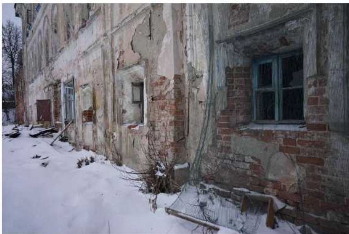
Фото 17. Фрагмент южного фасада. Наблюдаются разрушения, отслоения штукатурного и окрасочного слоев, обнажение и деструкция кирпичной кладки, разрушение декоративных элементов, следы поздних ремонтов. Отсутствует отмостка здания.
