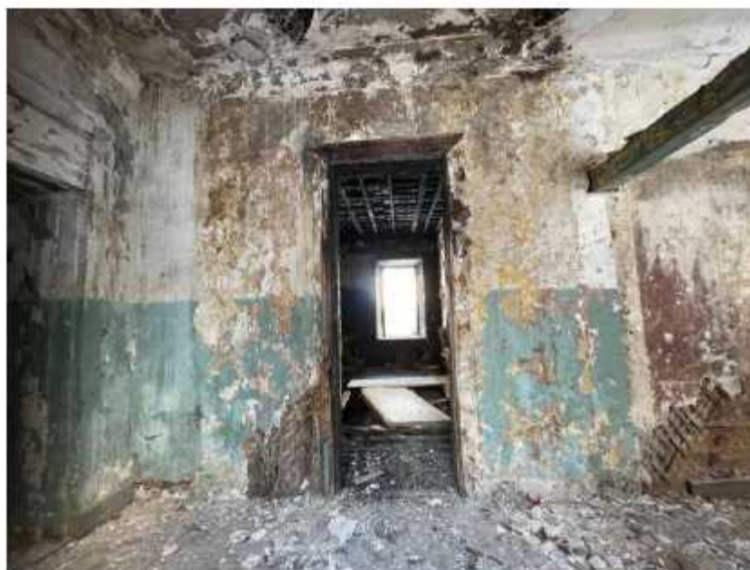
Фото 70. Помещение первого этажа главного объема. Наблюдаются следы разрушений от пожара, локальные утраты отделочных и штукатурного слоев, разрушение перегородки, разрушения покрытия пола, отсутствие дверных заполнений, многочисленные загрязнения.
