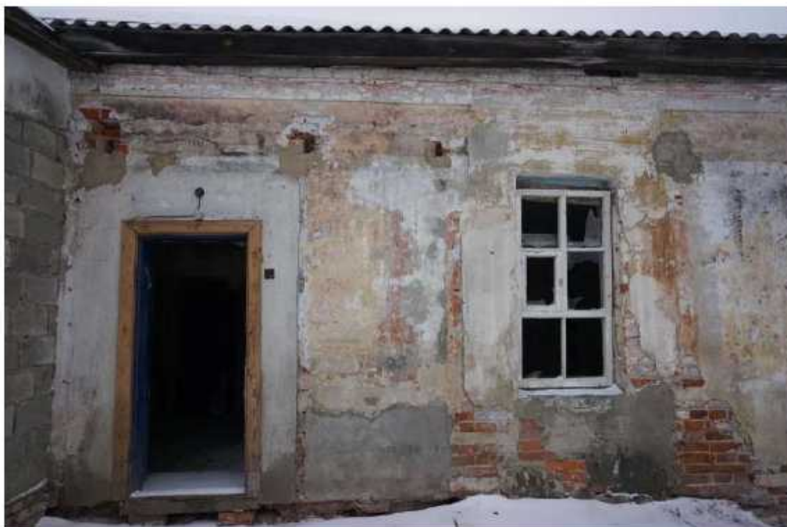
Фото 26. Фрагмент западного фасада восточного крыла. Наблюдаются разрушения штукатурного и окрасочного слоев, обнажение и деструкция кирпичной кладки, утрата декора. Видны следы поздних ремонтов, разрушение участка карниза. Отсутствует отмостка здания.
