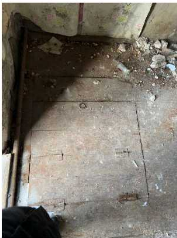
Фото 50. Помещение первого этажа восточного крыла. Наблюдаются потери цветового облика, локальная деформация, прогибы и следы замочаний деревянного пола. Разрушения отделочного слоя стен.
