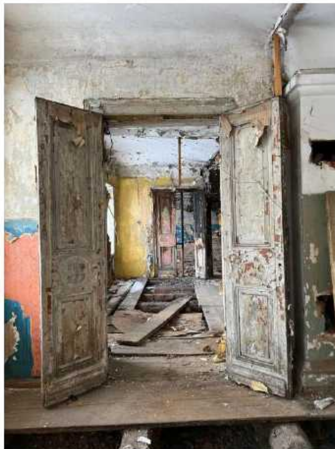
Фото 84, 85. Помещение второго этажа главного объема. Наблюдаются потери, отслоения отделочного и штукатурного слоев, разрушения деревянного пола, следы загрязнений и биопоражений. Сохранившееся дверное заполнение.
