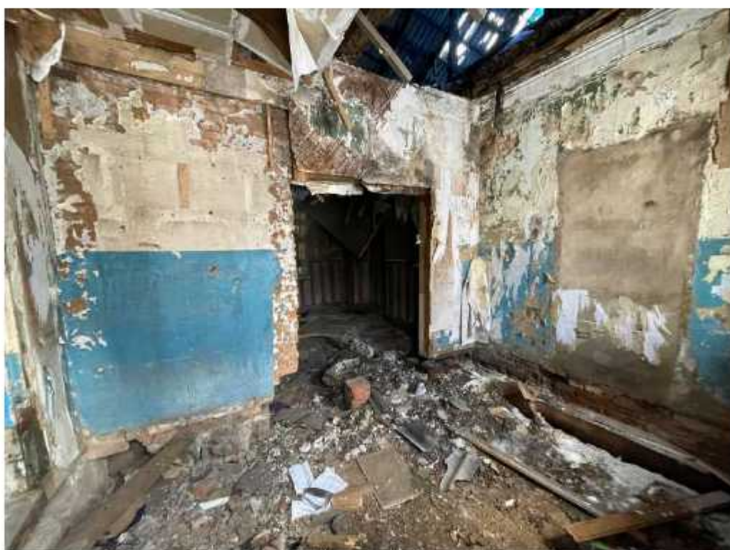
Фото 63. Помещение первого этажа восточного крыла. Наблюдаются следы разрушений от пожара, локальные утраты отделочных и штукатурного слоев, обнажение кирпичной кладки, разрушения деревянного пола, отсутствие дверных заполнений, многочисленные загрязнения. Наблюдаются утраты подкровельных конструкций.
