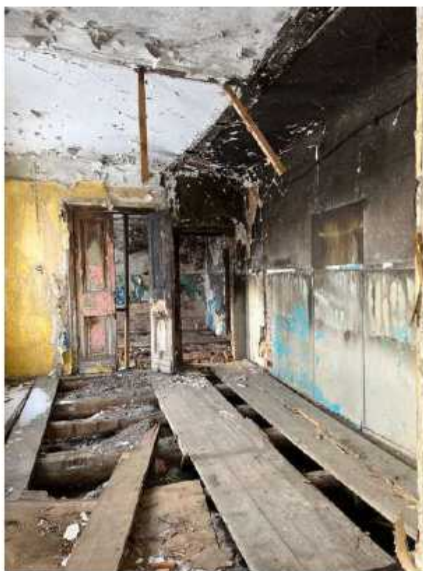
Фото 87. Помещение второго этажа главного объема. Наблюдаются следы пожара, разрушения деревянного пола, утраты отделочного и штукатурного слоев, следы биопоражений, следы намокания и загрязнений.
