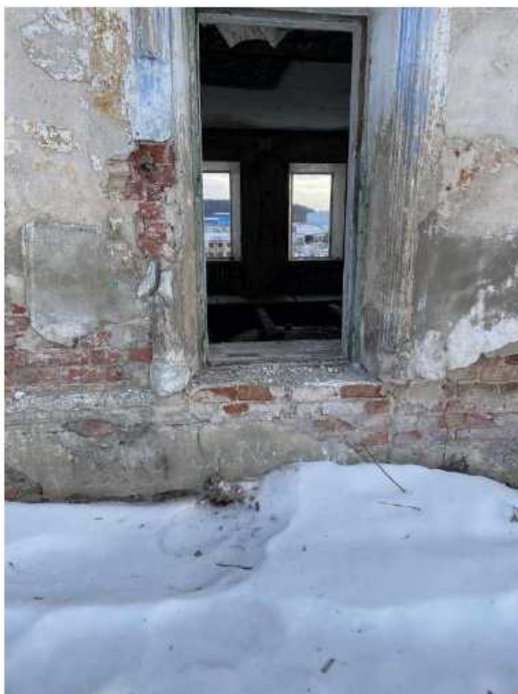
Фото 39. Фрагмент северного фасада. Наблюдаются разрушения штукатурного и окрасочного слоев, обнажение и деструкция кирпичной кладки, разрушения наличника и отсутствие оконного заполнения.
