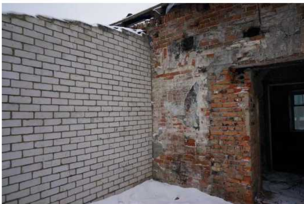
Фото 19. Фрагмент западного фасада восточного крыла. Наблюдаются разрушения штукатурного и окрасочного слоев, обнажение и деструкция кирпичной кладки, отсутствие дверного заполнения. Наблюдается пристройка позднего времени. Отсутствует отмостка здания. Разрушение кирпича в месте примыкания крыши к стене, деформация подкровельных конструкций.
