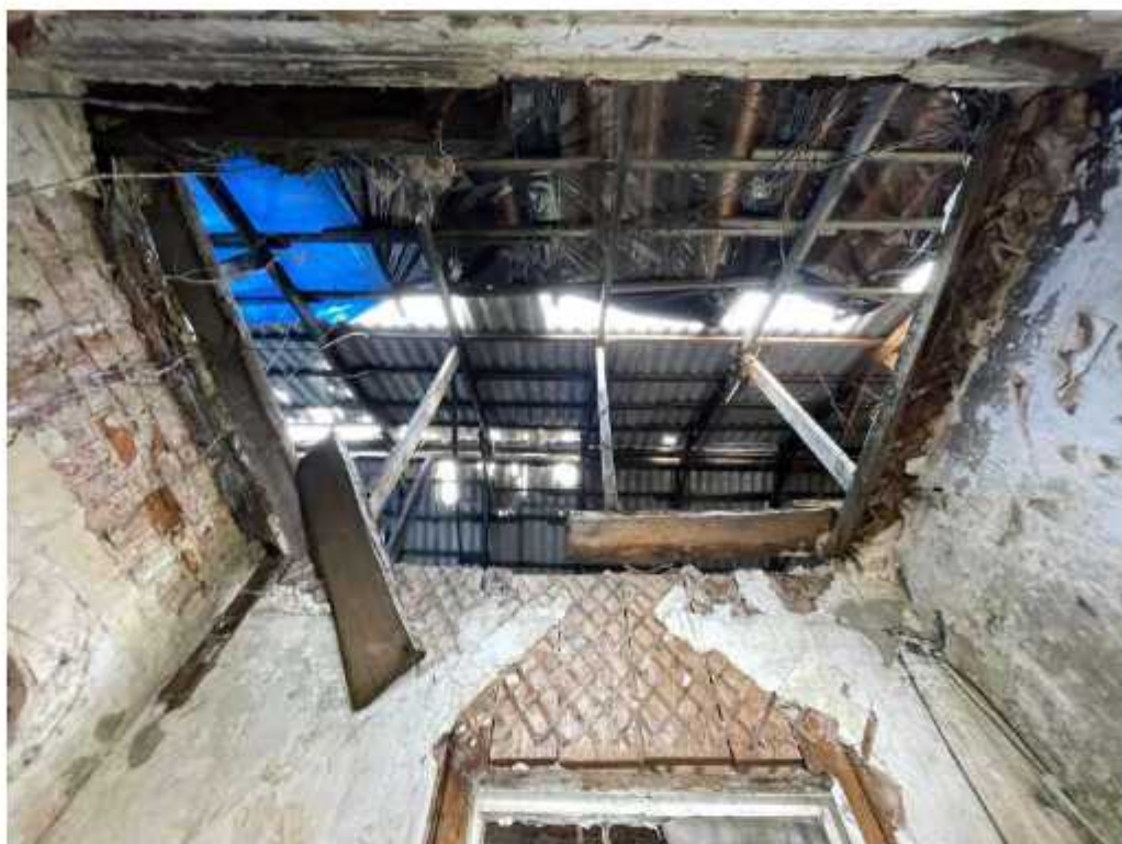
Фото 66. Помещение первого этажа восточного крыла. Наблюдаются обрушение чердачного перекрытия, утраты стропильной системы, обрешетки и кровельного покрытия, утраты отделочного и штукатурного слоев, следы загрязнения.
