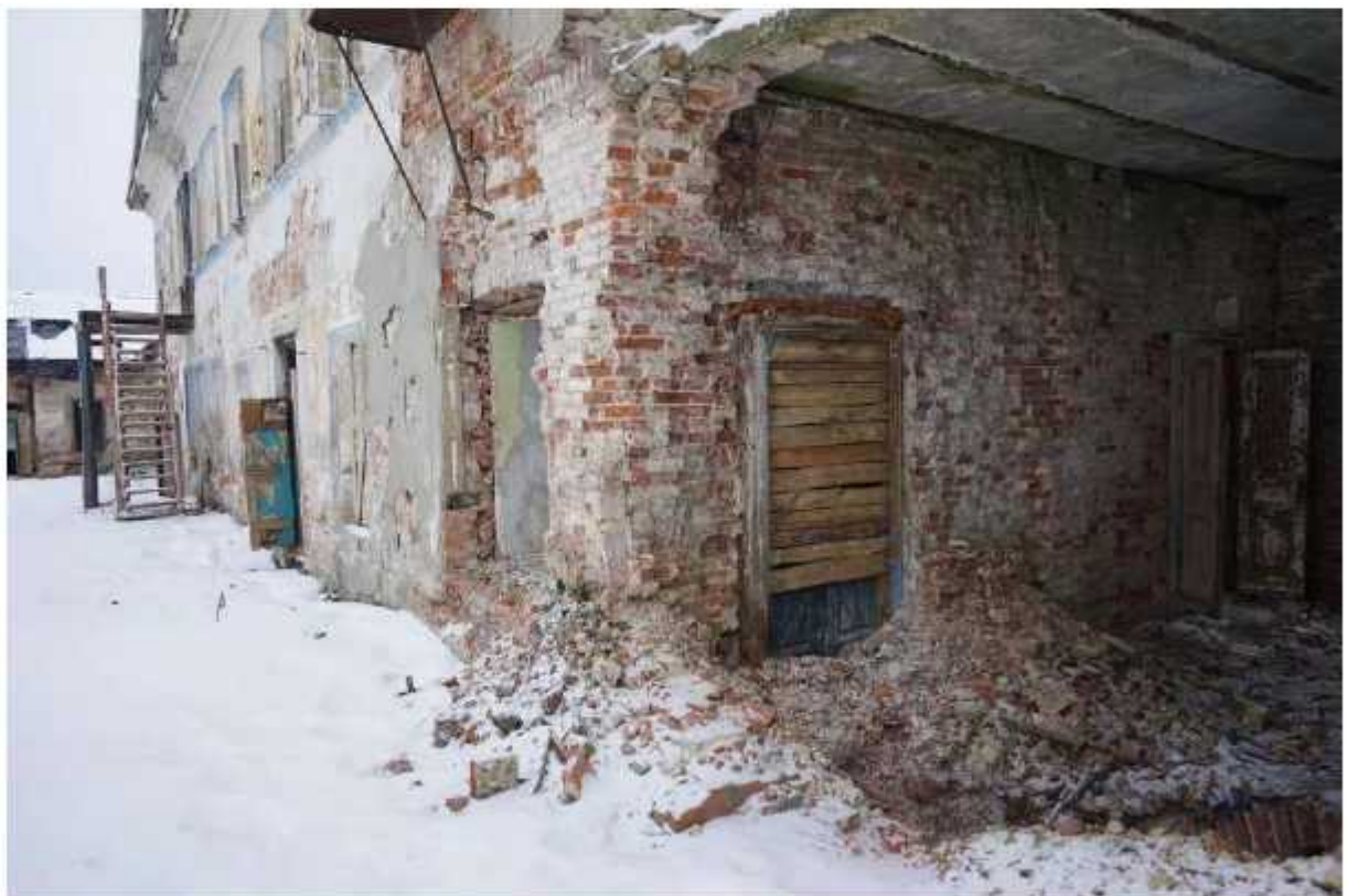
Фото 42, 43. Фрагмент северного фасада. Наблюдаются разрушения штукатурного и окрасочного слоев, обрушение наружной стены пристройки, обнажение и деструкция кирпичной кладки, утраты декора, разрушение кровельного покрытия, отсутствие отмостки здания.
