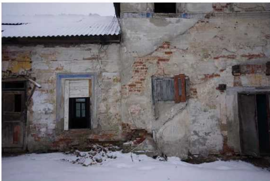
Фото 31. Фрагмент северного фасада. Наблюдаются разрушения штукатурного и окрасочного слоев, обнажение и деструкция, разрушение кирпичной кладки, утрата декора, утраты, деформация оконных и дверного заполнений, отсутствие отмостки, следы поздних ремонтов.
