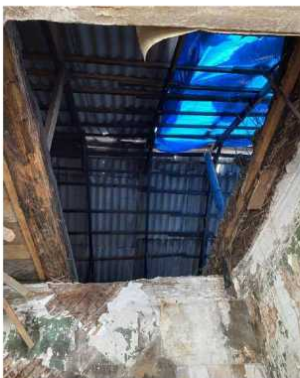
Фото 65. Помещение первого этажа восточного крыла. Наблюдаются обрушение чердачного перекрытия, утраты стропильной системы, обрешетки и кровельного покрытия, утраты отделочного и штукатурного слоев, следы загрязнения.
