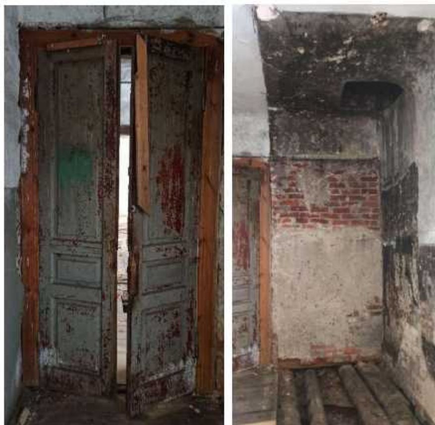
Фото 75, 76. Помещение второго этажа главного объема. Наблюдаются разрушения деревянного перекрытия, утрата отделочного и штукатурного слоев, оголение кирпичной кладки, разрушение деревянного перекрытия, деформация, утрата деревянного пола, следы пожара, потеря цветового облика деформация дверного заполнения. Сохранившееся дверное заполнение.
