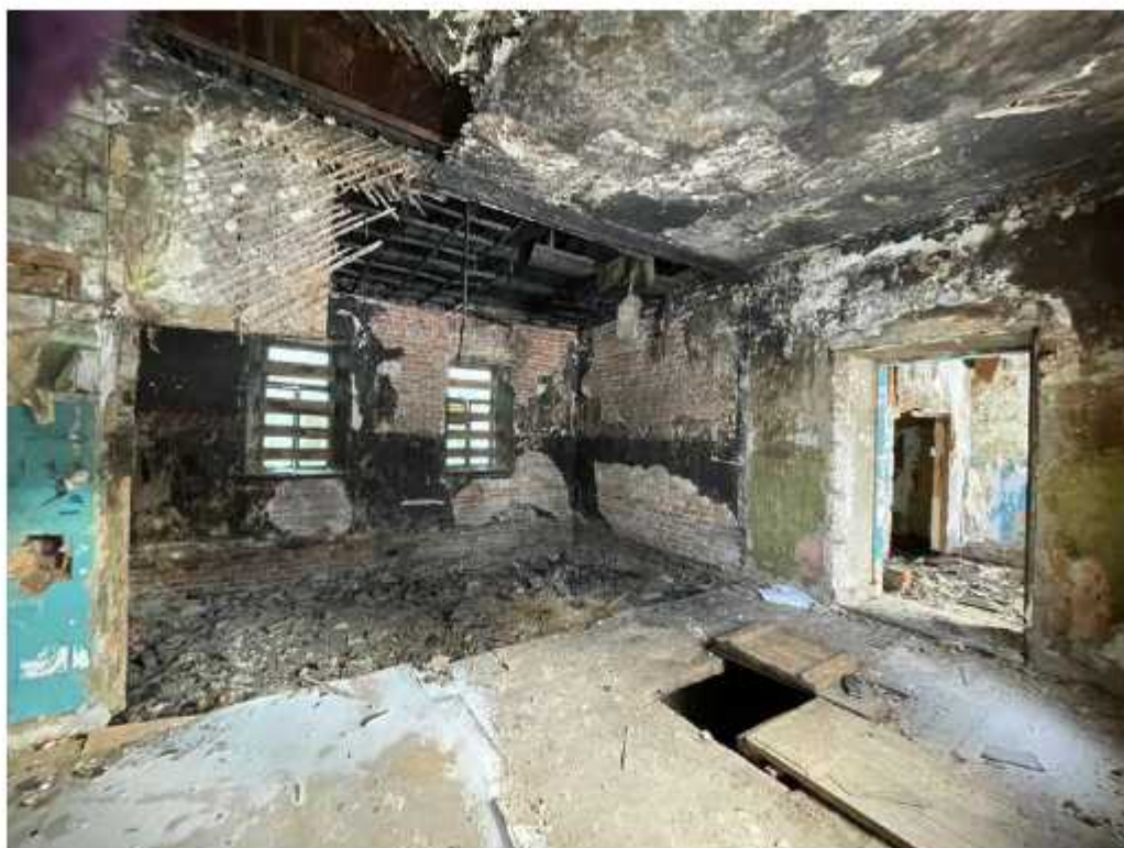
Фото 62. Помещение первого этажа восточного крыла. Наблюдаются следы разрушений от пожара, утрата отделочного и штукатурного слоев, разрушение перегородки, оголение кирпичной кладки, разрушения пола, отсутствие дверных заполнений.
