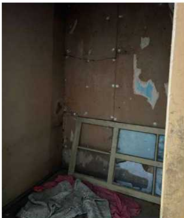
Фото 60. Помещение первого этажа восточного крыла. Наблюдаются утрата отделочного слоя стен и следы загрязнения.
