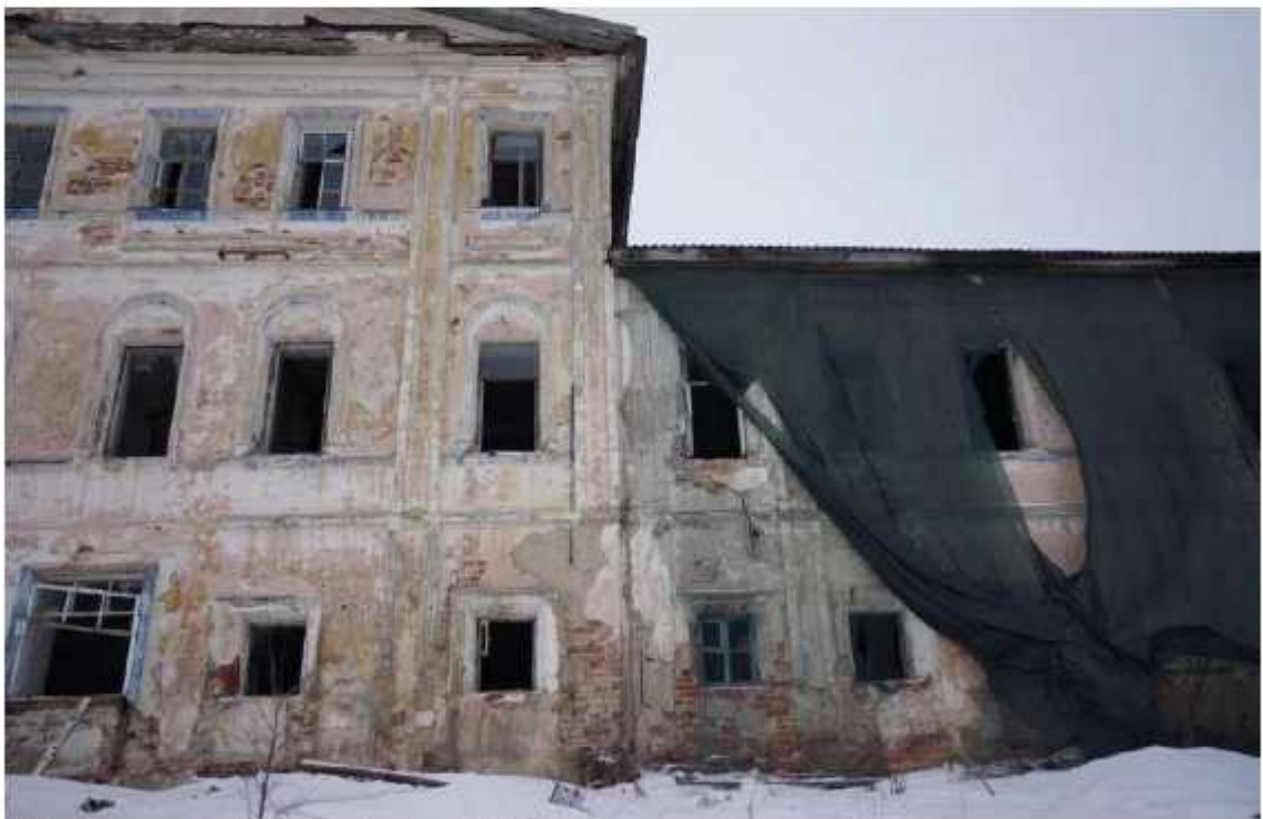
Фото 8. Фрагмент южного фасада. Наблюдаются разрушения штукатурного и окрасочного слоев, трещины, отслаивания и вспучивания, утраты штукатурного декора, обнажение и деструкция кирпичной кладки преимущественно в районе нижнего этажа здания. Отсутствуют отмостка здания и заполнения оконных проемов, видны следы позднего ремонта.
