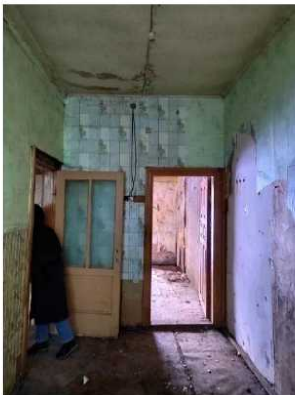
Фото 56. Помещение первого этажа восточного крыла. Наблюдается отслоение и деформация отделочного слоя потолка, следы замокания и биопоражений. Утраты отделочного слоя стен и полов, локальные прогибы деревянного пола.
