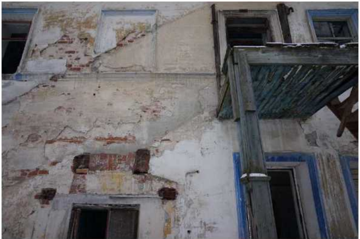
Фото 34. Фрагмент северного фасада. Наблюдаются разрушения штукатурного и окрасочного слоев, обнажение и деструкция кирпичной кладки, утрата декора, следы утраченной лестницы.
