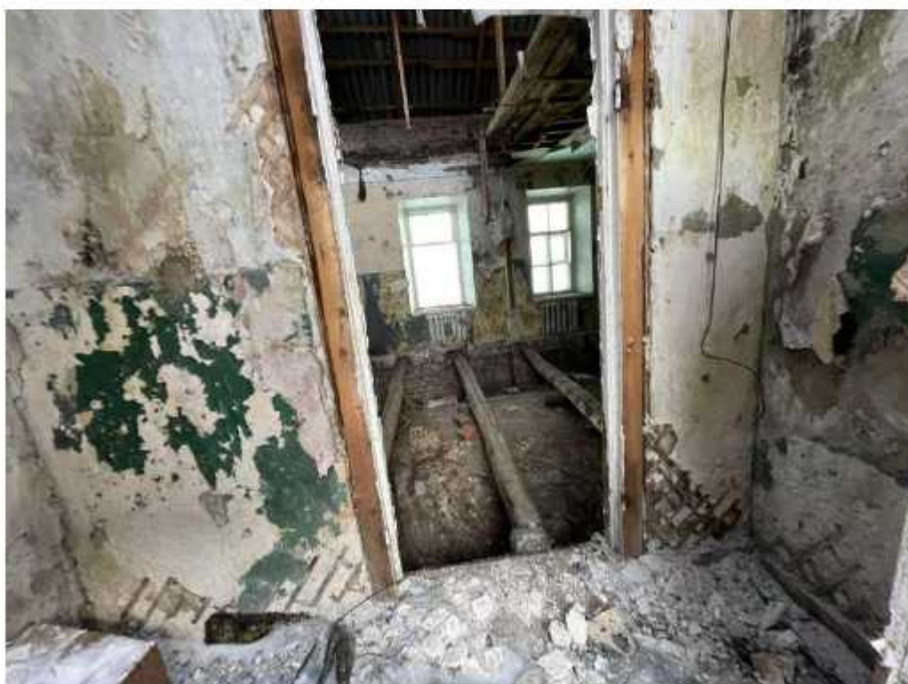
Фото 67. Помещение первого этажа восточного крыла. Наблюдаются потери, отслоения отделочного и штукатурного слоев, разрушения деревянного перекрытия, следы загрязнений и биопоражений.
