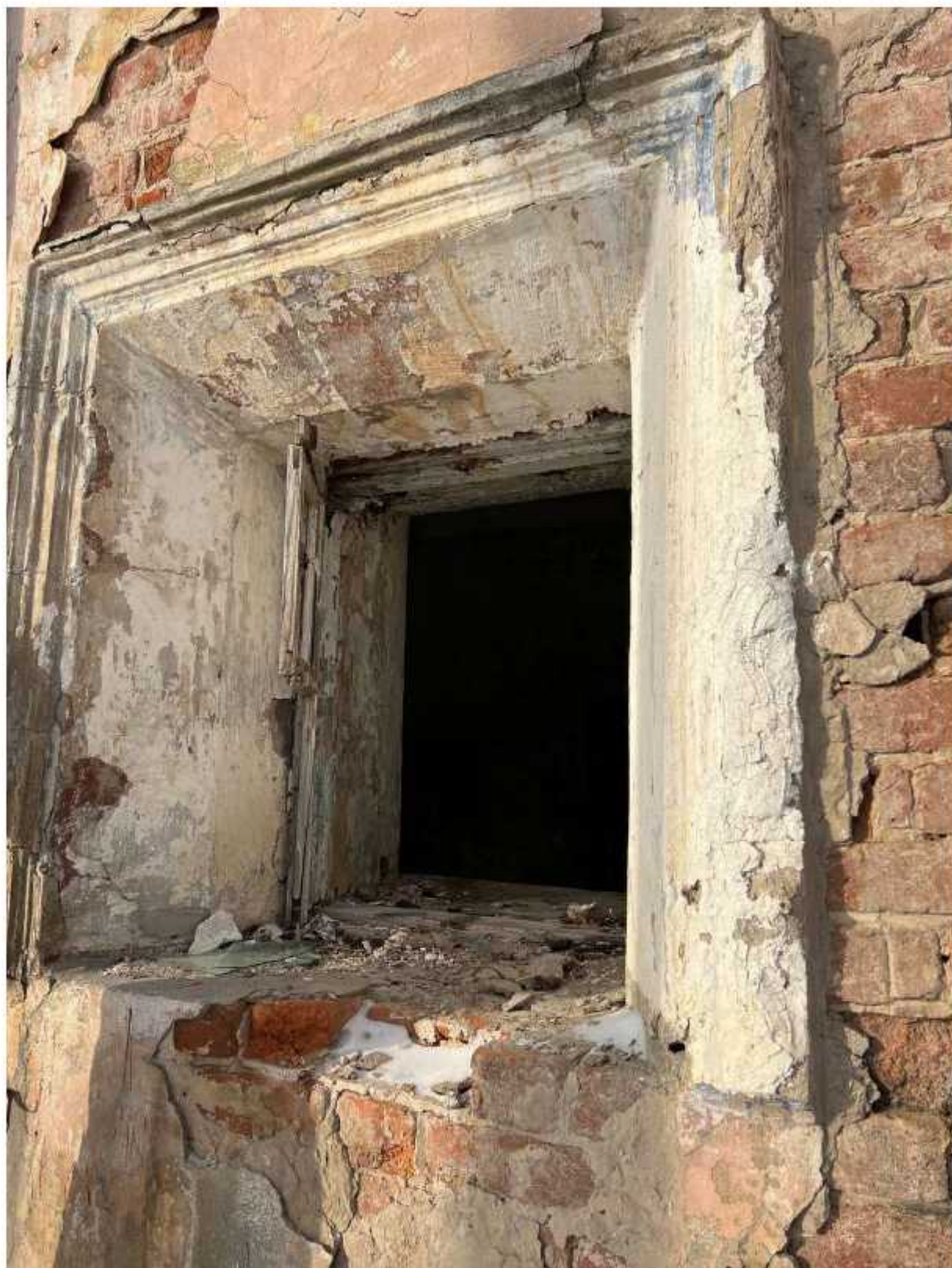
Фото 13. Фрагмент южного фасада. Наблюдаются разрушения, отслоение штукатурного и окрасочного слоев, обнажение и деструкция кирпичной кладки, разрушение тянутого наличника и отсутствие оконного заполнения.
