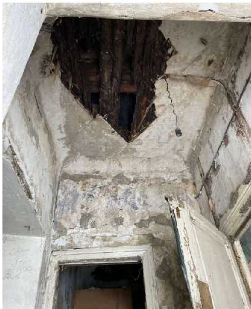
Фото 89. Помещение второго этажа главного объема. Наблюдаются обрушения отделочного и штукатурного слоев, оголение и деформация деревянного перекрытия, следы загрязнений и биопоражений.
