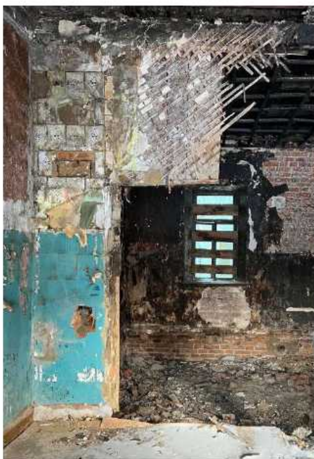
Фото 61. Помещение первого этажа восточного крыла. Наблюдаются следы разрушений от пожара, утрата отделочного и штукатурного слоев, разрушение перегородки.
