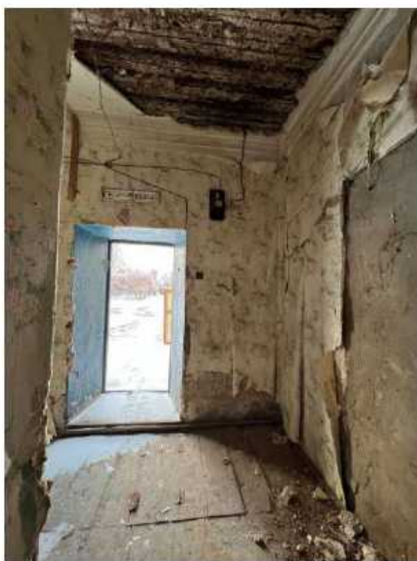
Фото 51. Помещение первого этажа восточного крыла. Наблюдаются утраты отделочного и обрушения штукатурного слоев поверхности стен и потолка, отсутствие дверного заполнения, следы замочания, очаги биопоражений. Рассыхание перекрытия (потолка).
