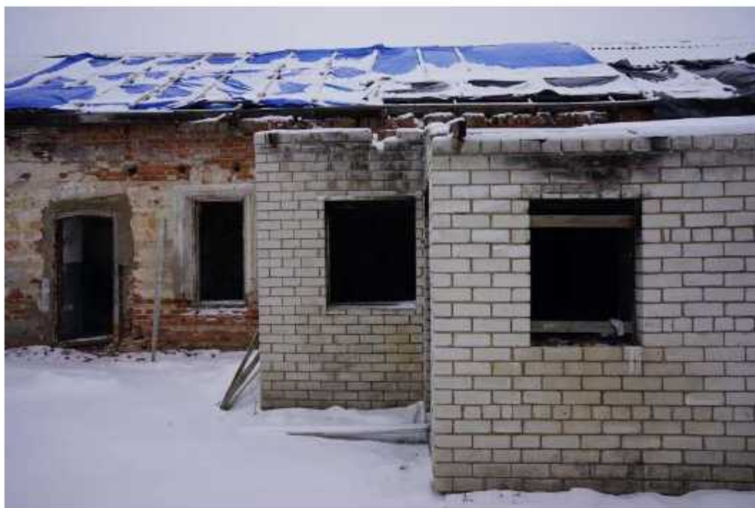
Фото 20. Фрагмент западного фасада восточного крыла. Наблюдаются разрушения штукатурного и окрасочного слоев, обнажение и деструкция кирпичной кладки, отсутствие дверного заполнения. Наблюдается пристройка позднего ремонта. Отсутствует отмостка здания. Многочисленные утраты кровельного покрытия, деформация подкровельных конструкций.
