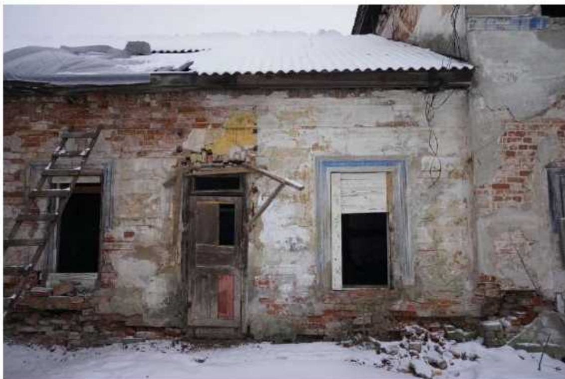
Фото 30. Фрагмент северного фасада. Наблюдаются разрушения штукатурного и окрасочного слоев, обнажение и деструкция кирпичной кладки, утрата декора, разрушения оконных и дверного заполнений, отсутствие отмостки, локальная утрата кровельного покрытия.
