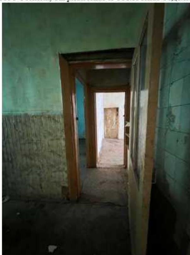
Фото 55. Помещение первого этажа восточного крыла. Наблюдается следы загрязнения, биопоражений поверхностей, локальные деформации покрытия пола.
