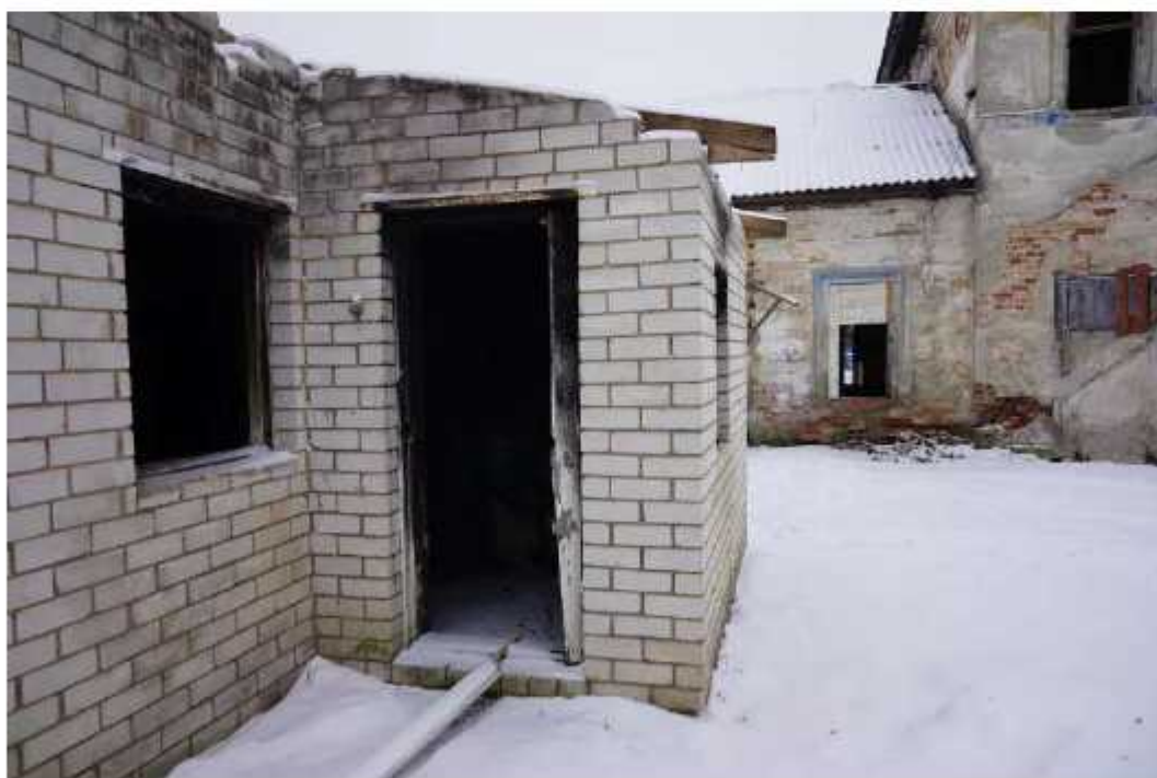
Фото 21. Фрагмент западного фасада восточного крыла. Наблюдаются следы пожара на пристройке, отсутствие оконного и дверного заполнений. Отсутствует отмостка здания. Разрушение кирпича в месте примыкания крыши к стене, деформация подкровельных конструкций и отсутствие кровельного покрытия.
