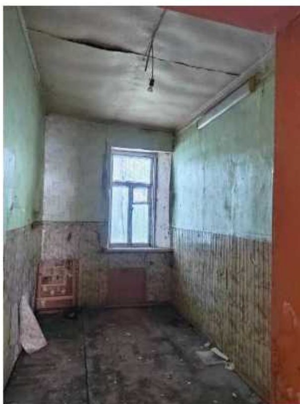
Фото 53. Помещение первого этажа восточного крыла. Наблюдается отслоение и деформация отделочного слоя потолка, следы замочания и биопоражений покрытия пола, потеря цветового облика, загрязнения и отслоения отделки стен.
