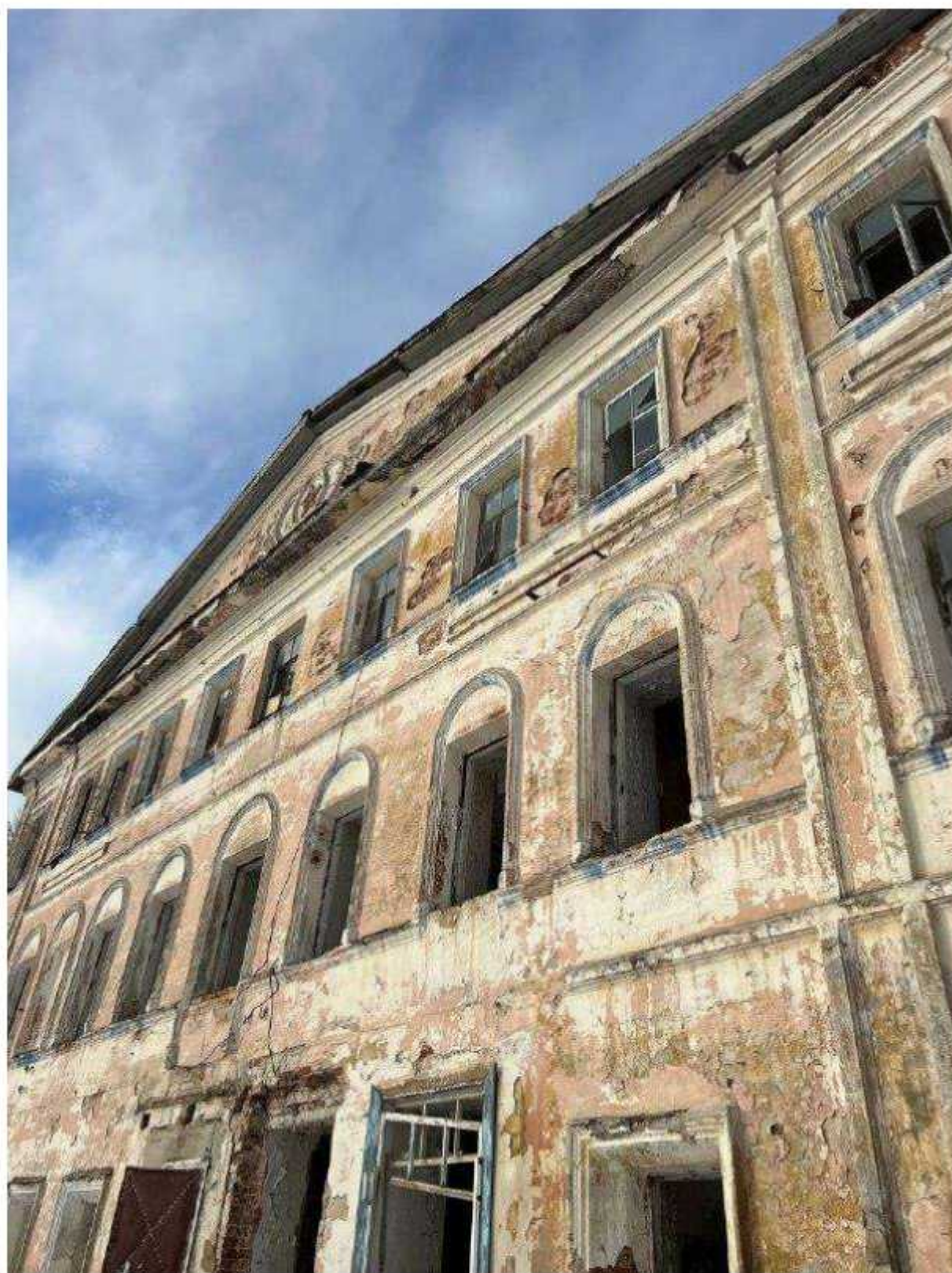
Фото 11. Фрагмент южного фасада (центральный объем). Наблюдаются разрушения штукатурного и окрасочного слоев, трещины с шириной раскрытия более 10 мм, утраты штукатурного декора, расшивка оконных проемов. Отсутствуют заполнения оконных проемов.
