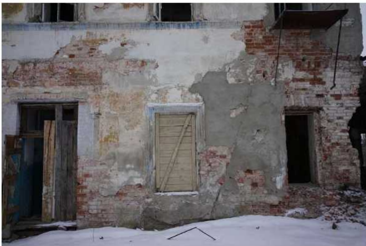
Фото 40. Фрагмент северного фасада. Наблюдаются разрушения штукатурного и окрасочного слоев, обнажение и деструкция кирпичной кладки, утраты декора, отсутствие отмостки здания.
