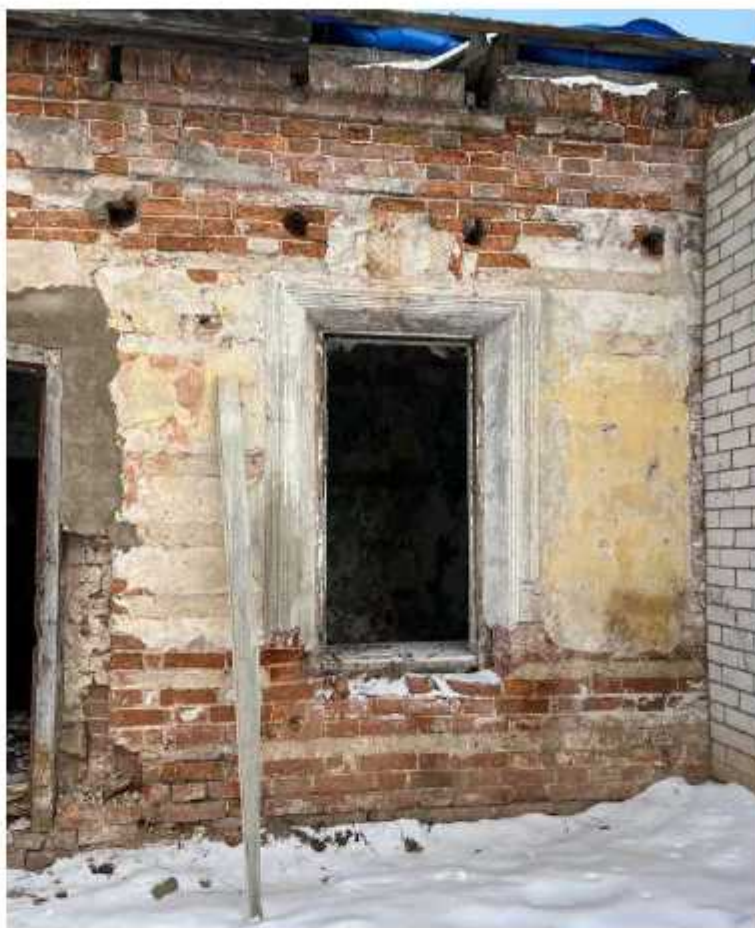
Фото 22. Фрагмент западного фасада восточного крыла. Наблюдаются разрушения штукатурного и окрасочного слоев, обнажение и деструкция кирпичной кладки, отсутствие оконного и дверного заполнений. Отсутствует отмостка здания. Видны значительные разрушения подкровельных конструкций и отсутствие кровельного покрытия.
