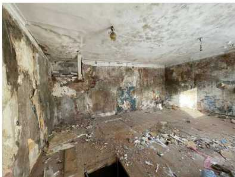
Фото 44. Помещение цокольного этажа главного объема. Наблюдаются утраты отделочного слоя поверхностей, отслоение штукатурного слоя, следы замокания, очаги биопоражений, многочисленные трещины, локальные деформации, прогибы деревянного перекрытия. Обнажение и деструкция кирпичной кладки. Разрушение декора.
