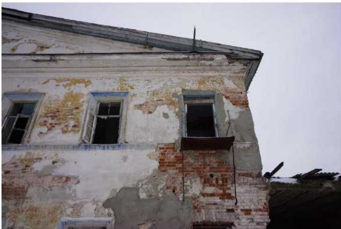
Фото 41. Фрагмент северного фасада. Наблюдаются разрушения штукатурного и окрасочного слоев, обнажение и деструкция кирпичной кладки, утраты декора, отсутствие отмостки здания.
