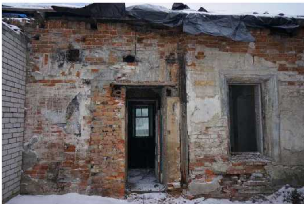
Фото 18. Фрагмент западного фасада восточного крыла. Наблюдаются разрушения, отслоения штукатурного и окрасочного слоев, обнажение и деструкция кирпичной кладки, разрушение декоративных элементов. Отсутствует отмостка здания. Многочисленные утраты кровельного покрытия, деформация подкровельных конструкций.
