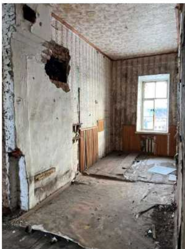
Фото 83. Помещение 2-го этажа главного объема. Наблюдаются потери, отслоения отделочных слоев, обнажение и деструкция кирпичной кладки, деформация покрытия пола, следы загрязнений и биопоражений
