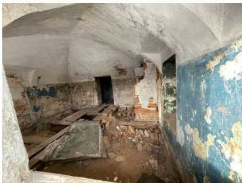
Фото 49. Помещение цокольного этажа восточного крыла. Наблюдаются утраты отделочного и штукатурного слоев, обнажение и деструкция кирпичной кладки, утрата деревянного пола, дверных заполнений, скопление мусора.
