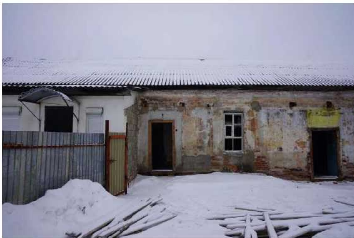
Фото 27. Фрагмент западного фасада восточного крыла. Наблюдаются разрушения штукатурного и окрасочного слоев, обнажение и деструкция кирпичной кладки, утрата декора. Видны следы поздних ремонтов, заделка дверных проемов, разрушение участка карниза. Отсутствует отмостка здания.
