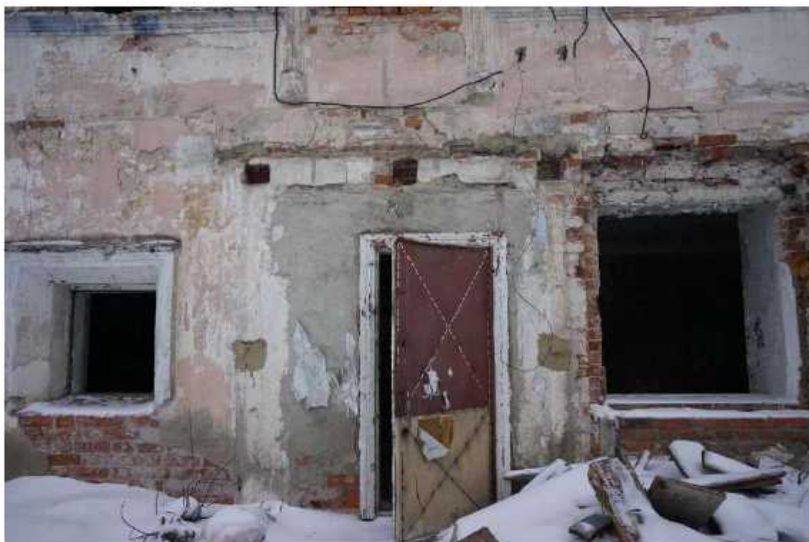
Фото 16. Фрагмент южного фасада. Наблюдаются разрушения штукатурного и окрасочного слоев, обнажение и деструкция кирпичной кладки, разрушение декоративных элементов, отсутствие оконных заполнений, отмостки здания.
