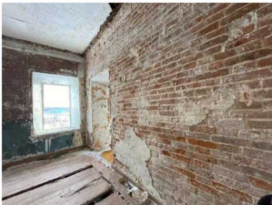
Фото 74. Помещение первого этажа главного объема. Наблюдаются рассыхание, трещины, разрушения деревянного покрытия пола. Потеря окрасочного и штукатурного слоев, оголение кирпичной кладки, утрата декора, оконного и дверного заполнений.
