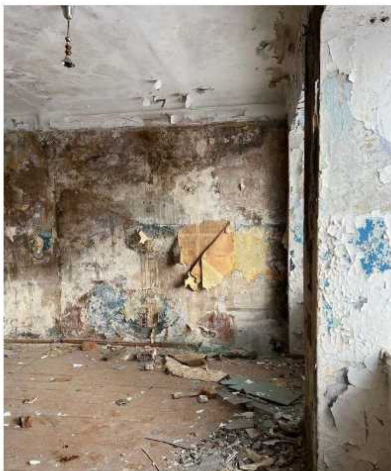
Фото 45. Помещение цокольного этажа главного объема. Наблюдаются утраты отделочного слоя поверхностей, отслоение штукатурного слоя, следы замокания, очаги биопоражений, многочисленные трещины, локальные деформации, прогибы деревянного перекрытия.
