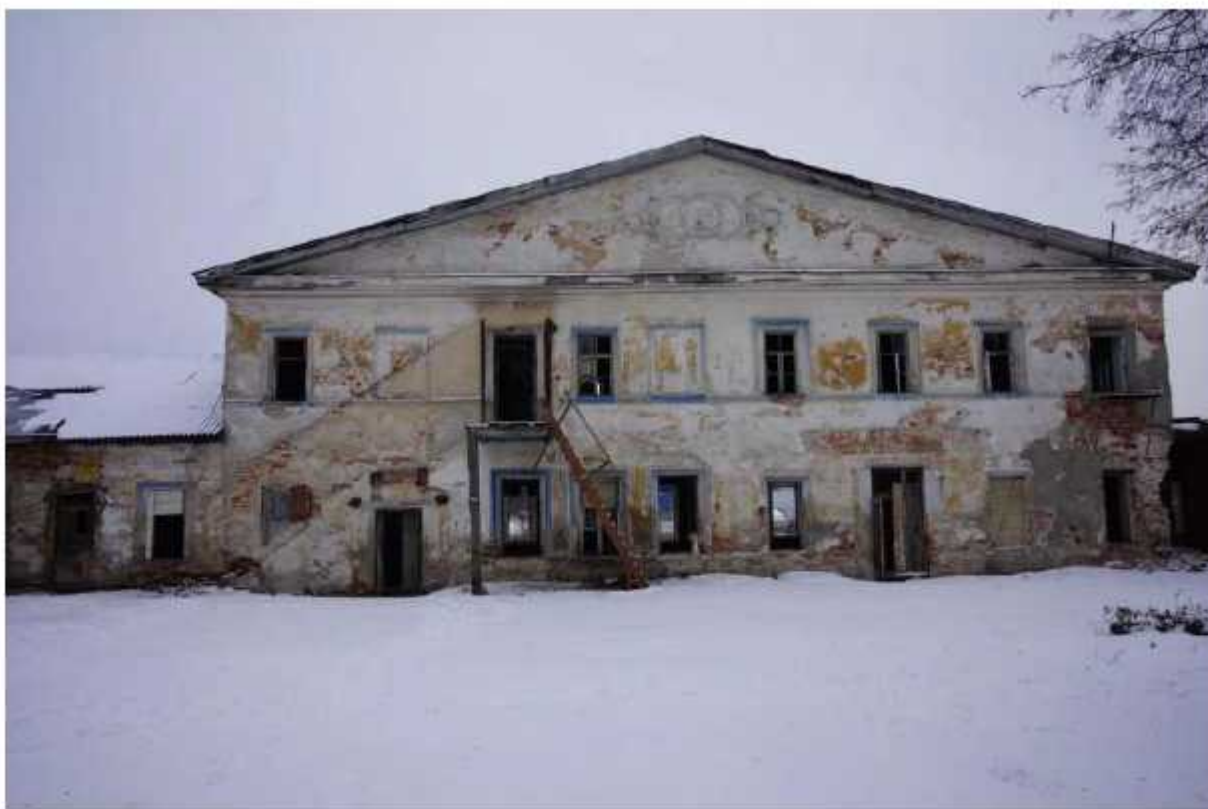
Фото 9. Северный фасад. Наблюдаются разрушения, отслаивания штукатурного и окрасочного слоев, обнажение и деструкция кирпичной кладки, утраты декора, оконных заполнений, отмостки здания. Видны поздние пристройки: лестница деревянная, следы утраченной лестницы со времен перепланировки здания.
