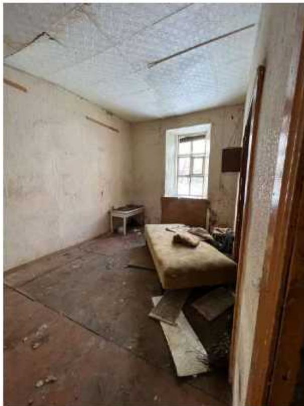
Фото 59. Помещение первого этажа восточного крыла. Наблюдаются провисания потолка, следы замокания и биопоражений, провисания покрытия пола. Разрушение и загрязнения отделочного слоя поверхности стен.
