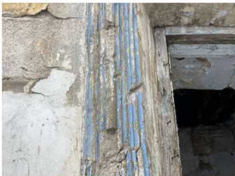
Фото 38. Фрагмент северного фасада. Наблюдаются разрушения штукатурного и окрасочного слоев, разрушения наличника и отсутствие оконного заполнения.
