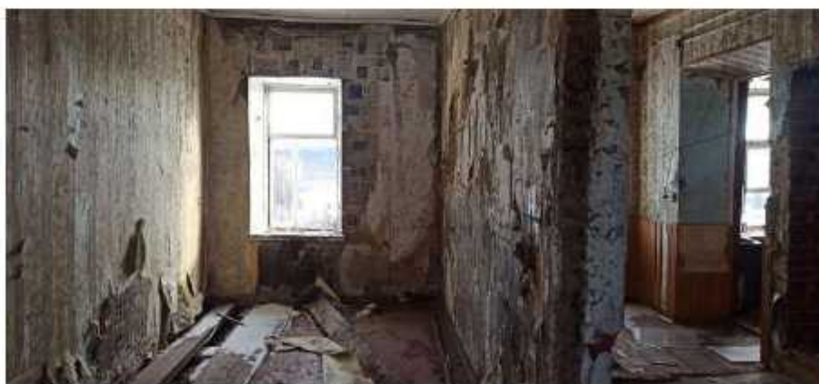
Фото 81. Помещение второго этажа главного объема. Наблюдаются следы разрушений, утраты отделочных и штукатурного слоев, разрушения деревянного пола.
