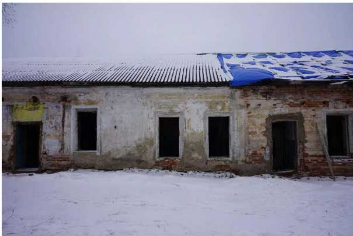
Фото 28. Фрагмент западного фасада восточного крыла. Наблюдаются разрушения штукатурного и окрасочного слоев, обнажение и деструкция кирпичной кладки, утрата декора. Отсутствие оконных и дверных заполнений, отмостки здания. Локальные утраты кровельного покрытия.
