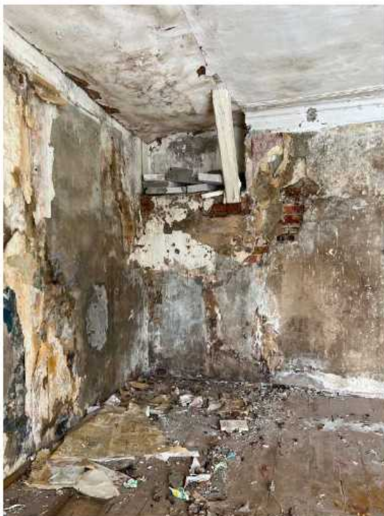
Фото 46. Помещение цокольного этажа главного объема. Наблюдаются утраты отделочного слоя поверхностей, отслоение штукатурного слоя, следы замокания, очаги биопоражений поверхностей. Обнажение и деструкция кирпичной кладки. Разрушение декора.
