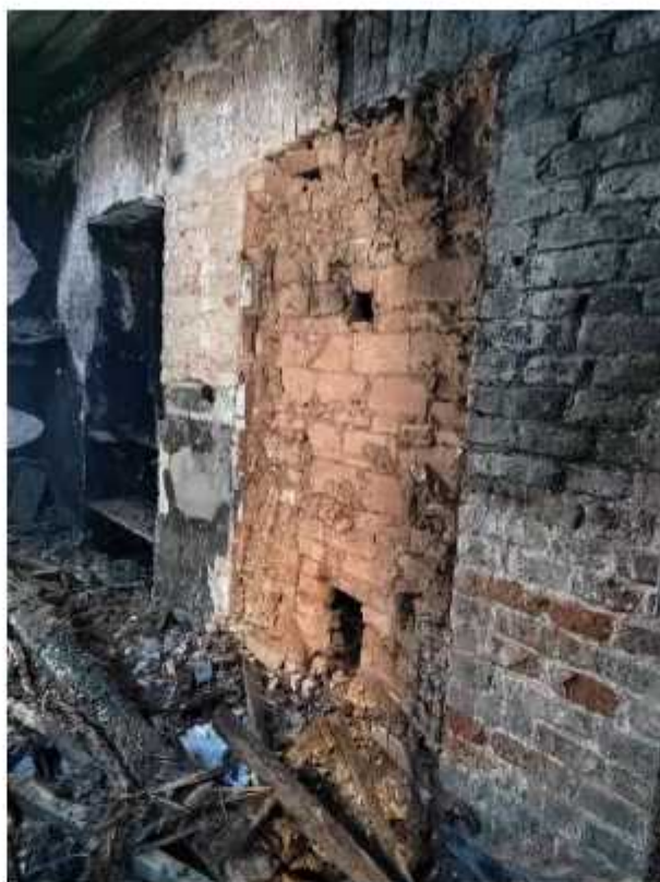
Фото 64. Помещение первого этажа восточного крыла. Наблюдается деструкция кирпичной кладки, следы от пожара, разрушение балок перекрытия, скопление мусора.
